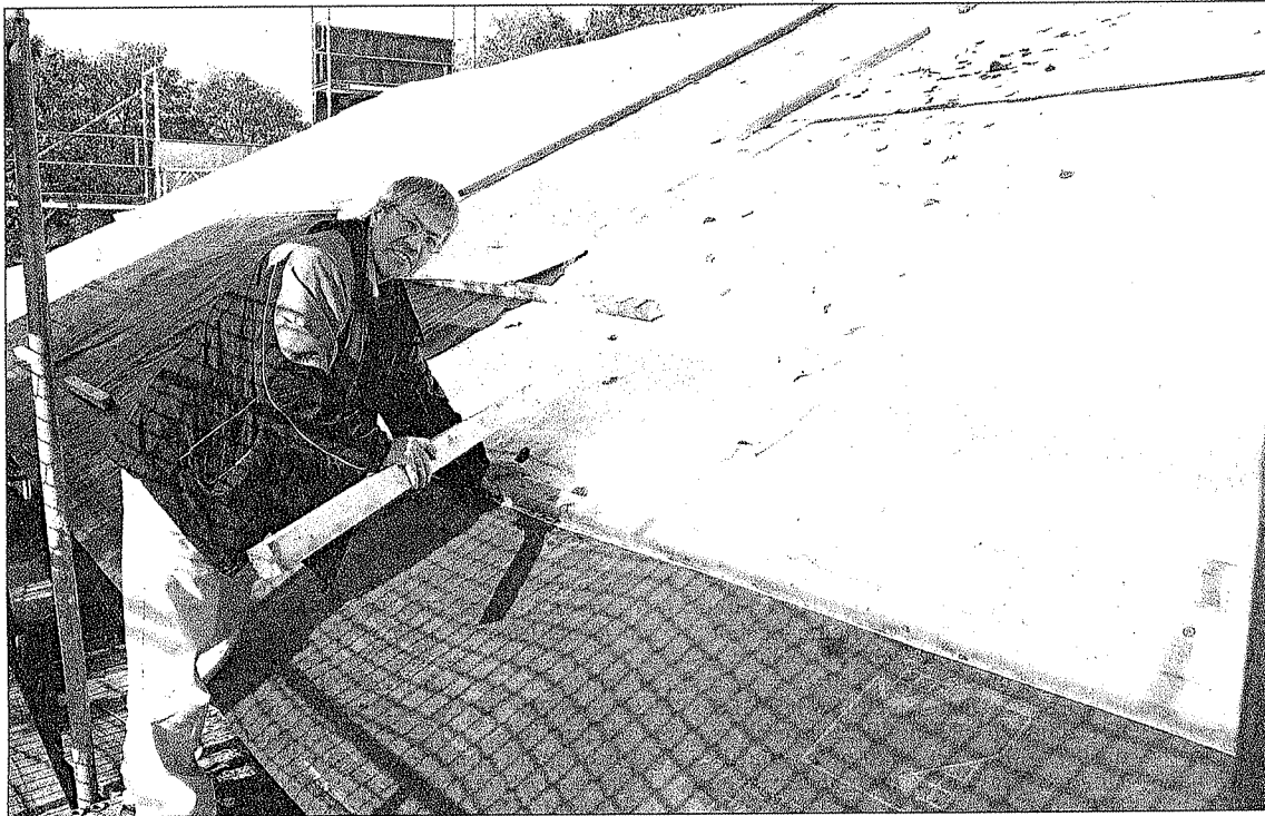
In sechs Wochen soll auf der Bethlehem-Kirche wieder ein Dach liegen. Pastor Volker Landa glaubt, dass die Kirche auch schon früher mit Schieferplatten eingedeckt war. Foto Krause
